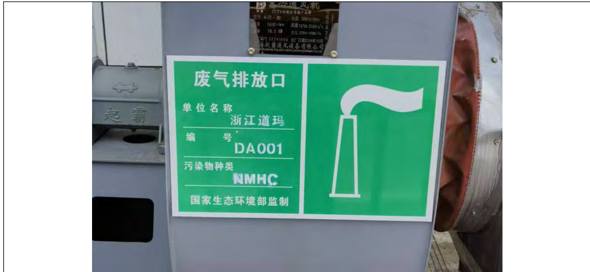
图 6 废气处理装置及标识牌
