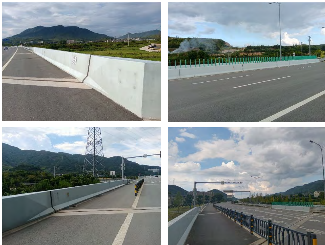
图 11.1-1 工程防撞护栏照片
