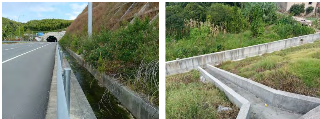
图 9.2-1 工程两侧路面径流收集系统照片
