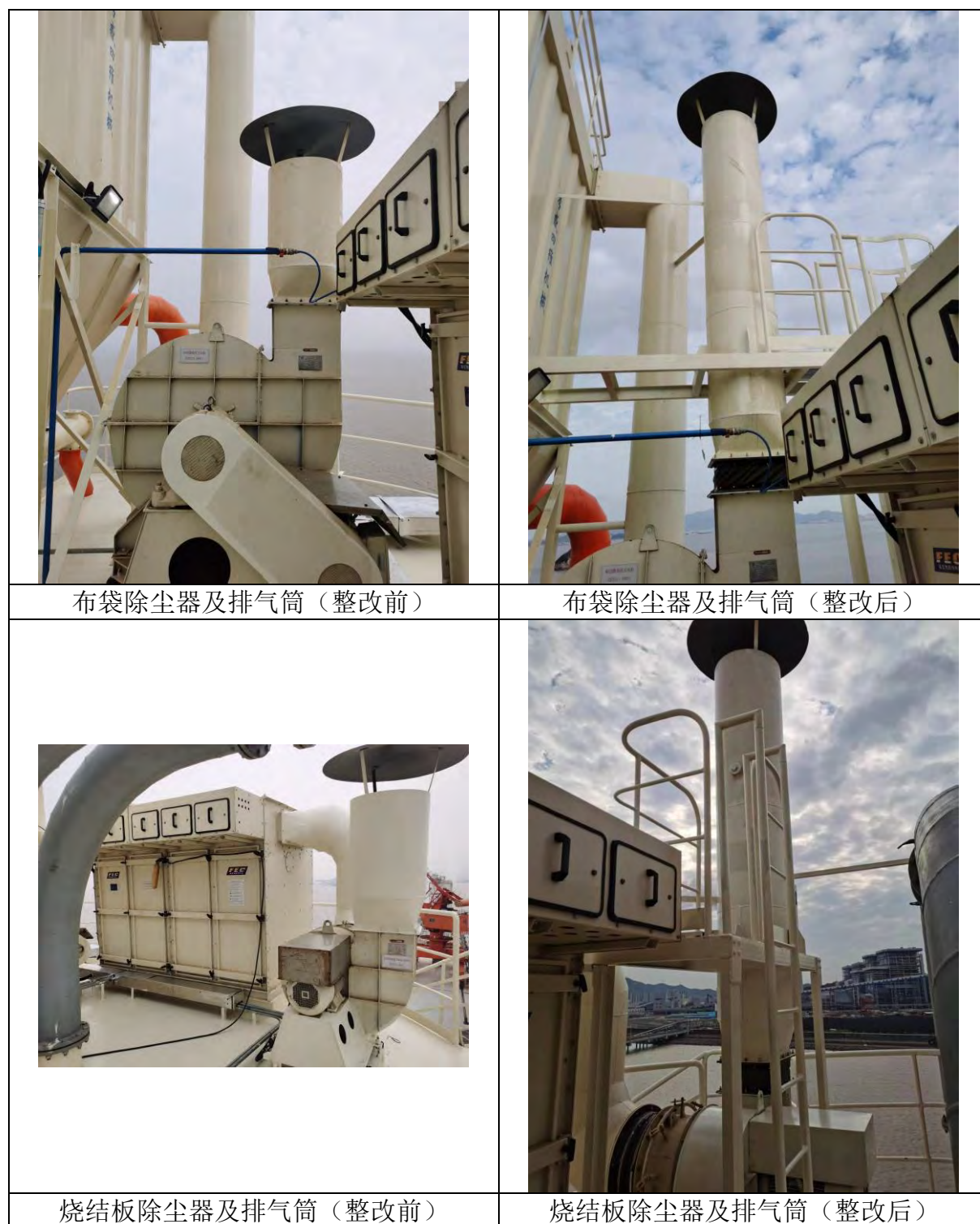
图 4-4 除尘器及排气筒整改前后对比照片
